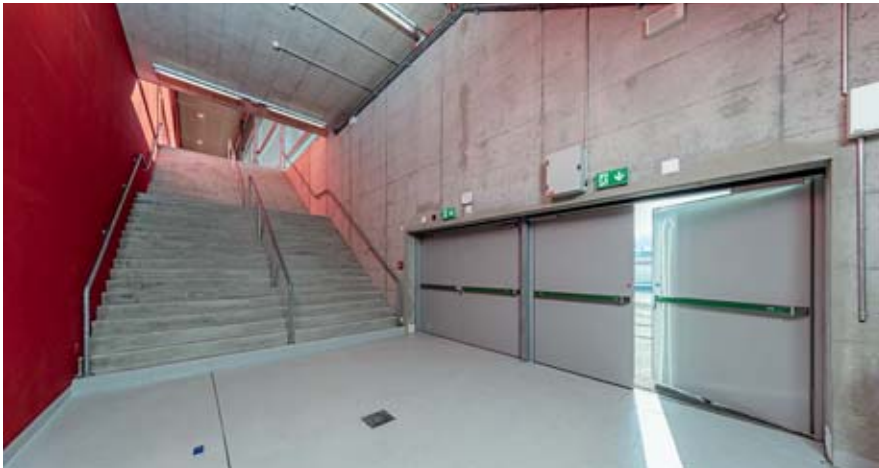
Bild 2: Mit kontrolliertem Überdruck hält die Rauchschutzdruckanlage (RDA) Treppenhäuser im Brandfall rauchfrei, sodass Flucht- und Rettungswege von Menschen im Gebäude und von der Feuerwehr genutzt werden können
